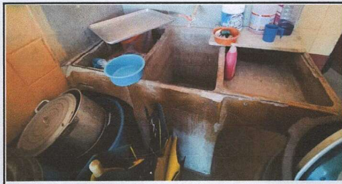
Foto 6: La pila actual es de dos lavaderos pero ya se encuentra rajada y el deposito de agua tiene fugas por lo que es necesario sustituirla por una del mismo tipo para que se ajuste al espacio actual
