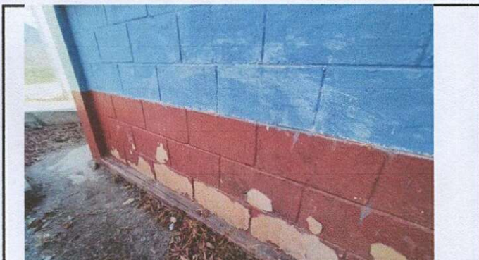
Foto 3: La pintura en las paredes interiores y exteriores muestra un deterioro originado por el paso del tiempo, llegando incluso a estarse desprendiendo, lo que requiere una aplicación nueva de pintura
