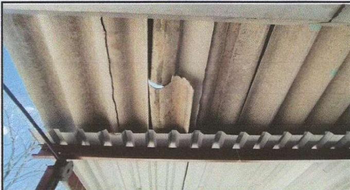
Foto 1: La estructura y cubierta de lámina requiere un remozamiento, sustituyendo la lamina de asbesto cemento por lámina troquelada y sustituyendo la estructura por costanera de metal resistente.
