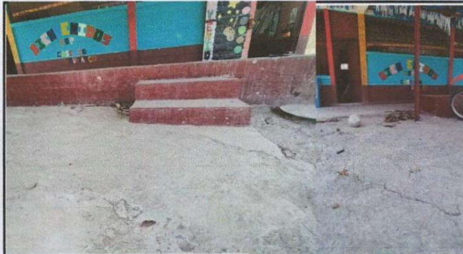
Foto 2: El piso del patio y salón de usos múltiples de la escuela se ha rajado y se está descascarando, lo que requiere un sustitución del piso de concreto en todo el espacio.
